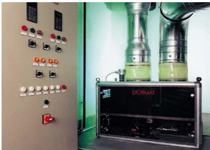
Bild 2: Raumluft-Essenzen-Zugabe (REZ) als Zusatzkomponente zur RLT-Anlage
